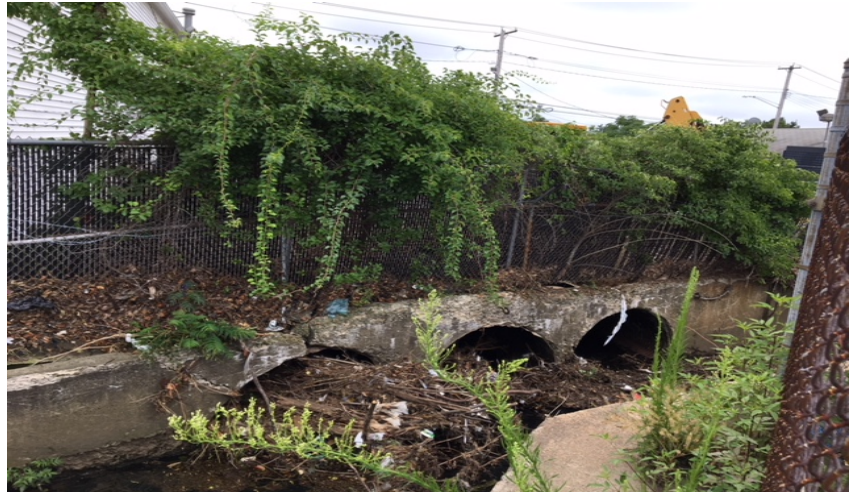
Esta foto de Bruce Brook muestra una pared de concreto significativamente dañada y tuberías de alcantarilla obstruidas causadas por escombros.
